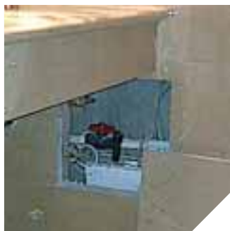
Sanipack установлен за стеной с монтажным люком
