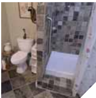
Ванная комната на цокольном этаже, подсоединенная к насосу Sanipro, скрытому в стене
