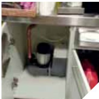
Sanicom, установленный в шкафу
