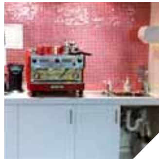
Слив раковины происходит в Sanispeed
