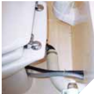
Вид на соединения унитаза системы Sanimarin
