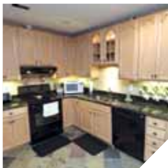
Кухня цокольного этажа: слив раковины и посудомоечной машины подсоединен к насосу Sanitive компании SFA
