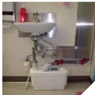
Sanivite, установленный в комнате 2
