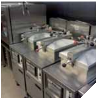
Кухонные плиты, стоящие на отделении от канализационной трубы
