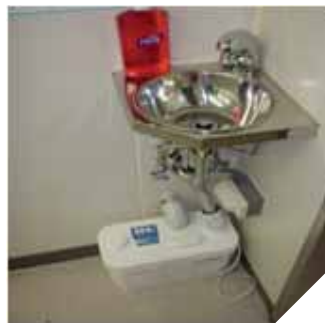
Sanivite, установленный в комнате 1
