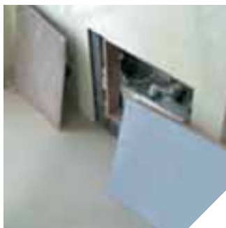
Sanipack установлен за стеной
